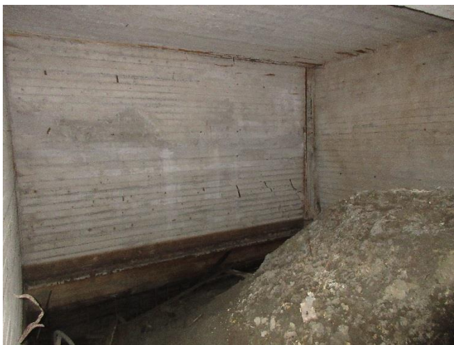
Bild 25. Utgångsläge. I krypgrunden fanns vatten och gammalt formverk.
