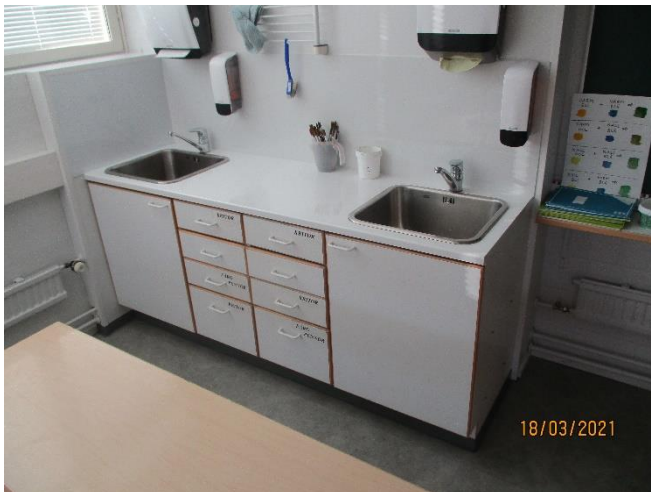
Bild 54. En avloppslukt upplevdes i utrymmet, efter att vatten tappats i båda lavoarerna försvann lukten.
