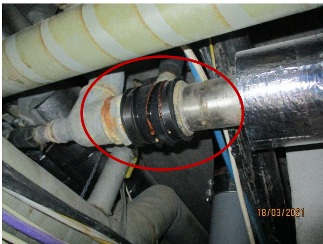
Bild 60. Ett mindre droppläckage observerades från ett värmerör i det område där teknikrum slutar och korridor in mot krypgrund börjar. Rekommenderas att man ser över och åtgärdar läckaget.
