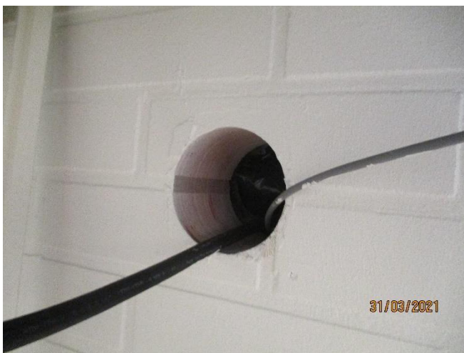
Bild 52. Enda läckaget som konstaterades var vid hål i ytterväggen ämnat för friskluftsventil. Ventilen är tillfälligt borta och man har dragit kablar genom hålet till en barack som används medan arbeten pågår i rummet. Ventilen kommer att sammanfogas med rör inne i väggen och silikon kommer dras runt ventilen. Läckaget borde sluta då ventilen är tillbaka på plats.
