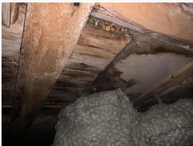
5.6.4. Spår av läckage i golvbjälklag
