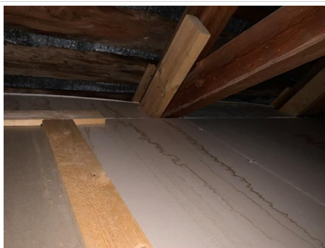
5.7.4. Yttervägg på vinden, spår av läckage
