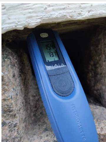
5.7.3. Fuktkvotsmätning av ytterväggsstock
