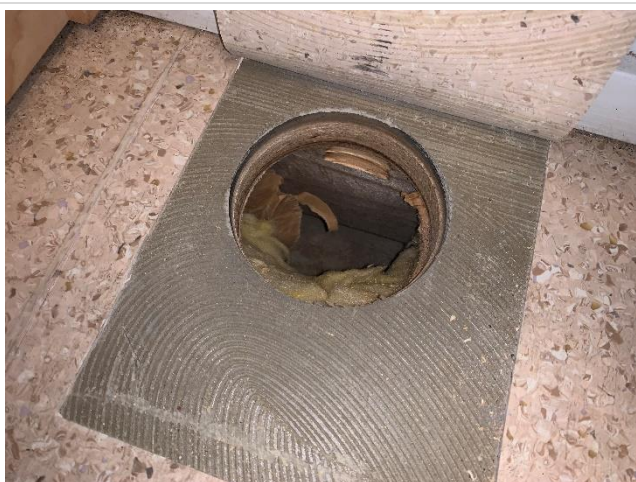
5.6.5. Håltagning i farstugolv, en unken lukt finns i golvet
