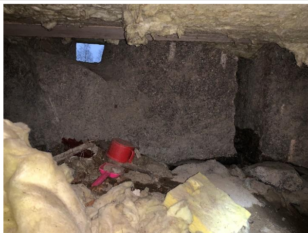
5.5.4. Mycket skräp och byggrester inne i krypgrunden
