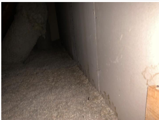
5.11.2. Övre bjälklag, spår av fukt vid randområdet mellan lösull och gippskiva
