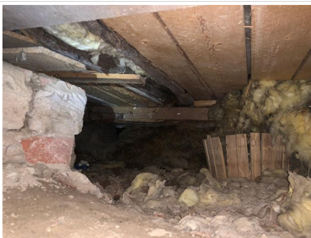
5.6.6. Mycket byggrester finns i krypgrunden
