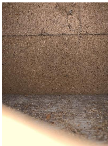
5.7.6. Spånskiva i yttervägg i krypgrund.
