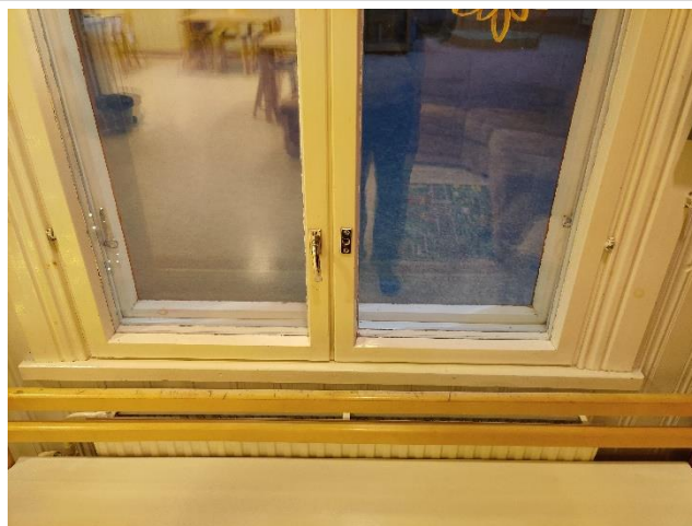
5.14.2. Fönster, inre bågen är förnyad
