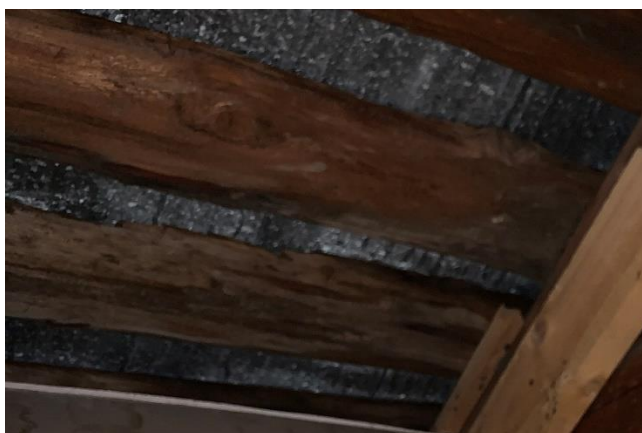
5.13.4. Taket saknar undertak
