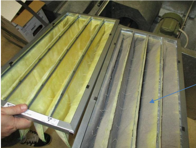
Bild 45. Daghemmet Frånluftmaskin PK4. Filterpåsen har brustit och är smutsig.
