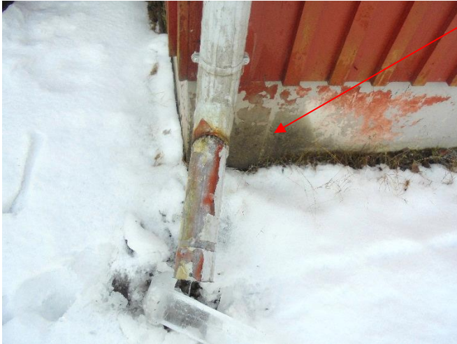
Bild 24. Regnvattnet leds inte bort i hörnet.
