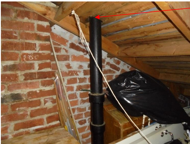
Bild 17. Träkonstruktionerna har mörknat runt genomföringarna och ställvis observerades rinnmärken.
