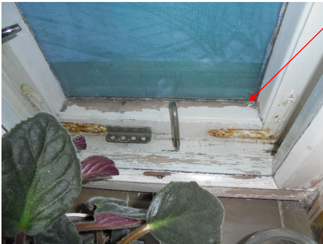
Bild 10. Fönstren i bostadshuset är ursprungliga och i dåligt skick.
