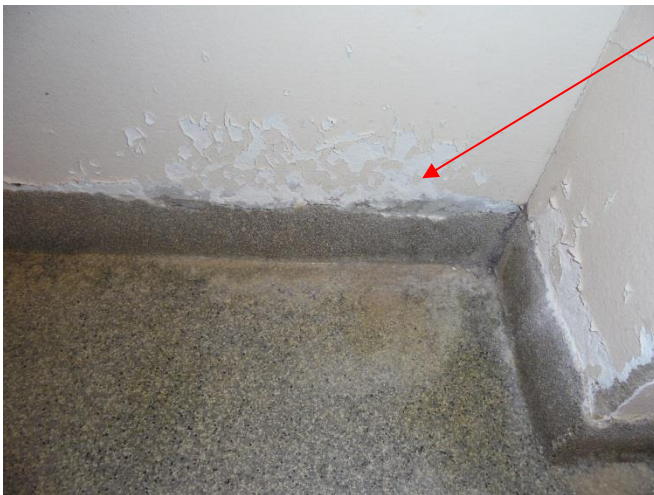
Bild 30. Vid ingången från matsalen flagnar målarfärgen i nedre kant av väggen.
