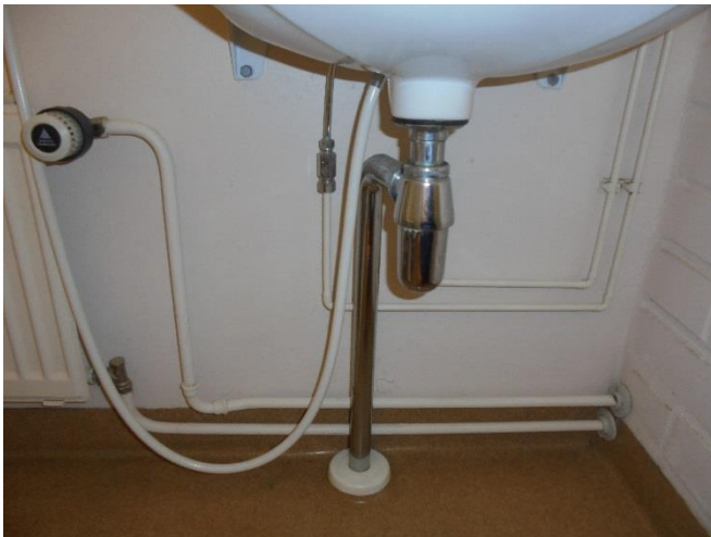
Bild 48. Synliga rördragningar granskades okulärt.
