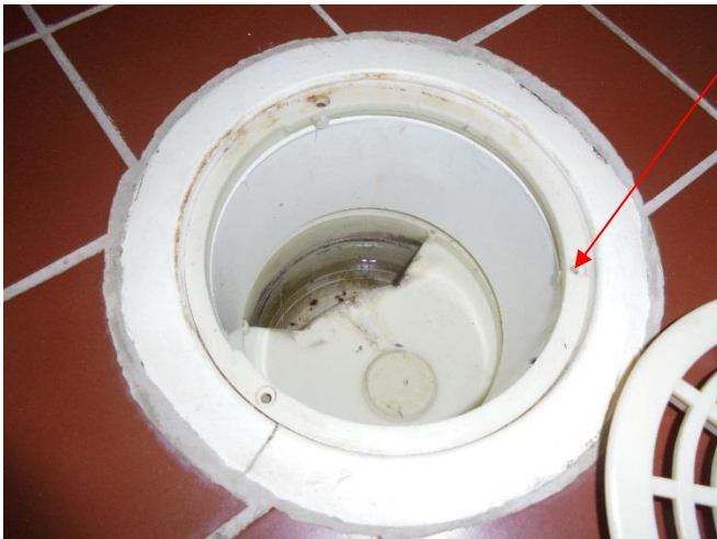
Bild 49. Spänningen saknar skruvar.
