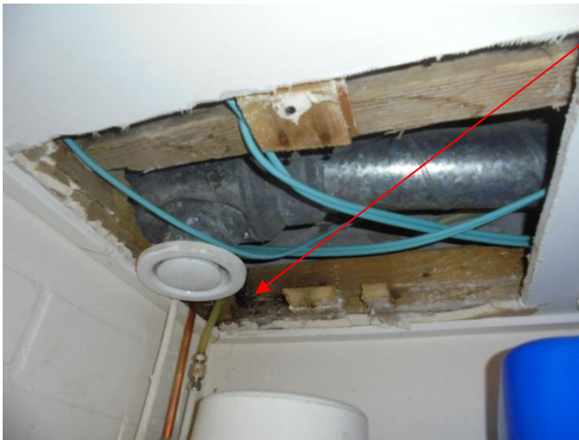
Bild 27. I städskrubben observerades fuktmärken i takkonstruktionerna. Spikarna har rostat samt träkonstruktionerna har mörknat.
