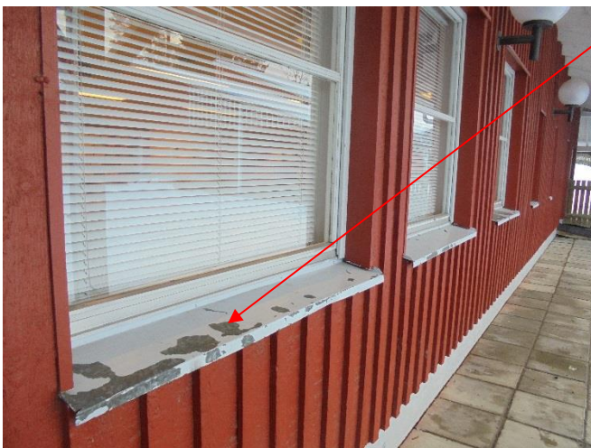
Bild 11. Målarfärgen flagnar från fönstreplåtarna.
