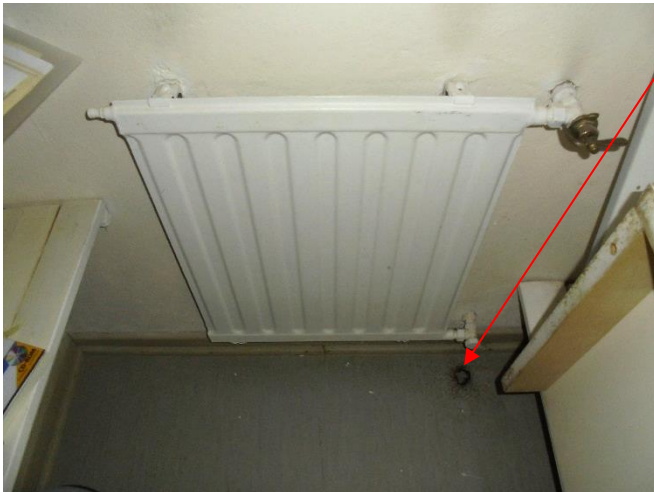
Bild 52. Läckage från värmeelementet i skrubben.
