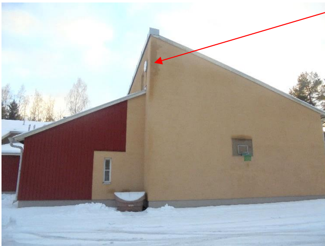
Bild 8. Fuktmärken observerades ställvis i övre kanten av väggen, utskiftet är mycket kort och vattnet kommer åt att rinna längs med fasaden.
