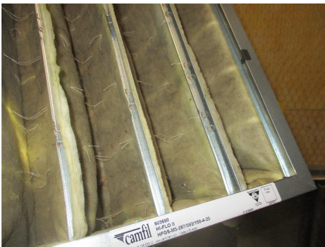
Bild 46. Daghemmet Tilluftmaskin TK4. Filterpåsen har brustit och är smutsig.
