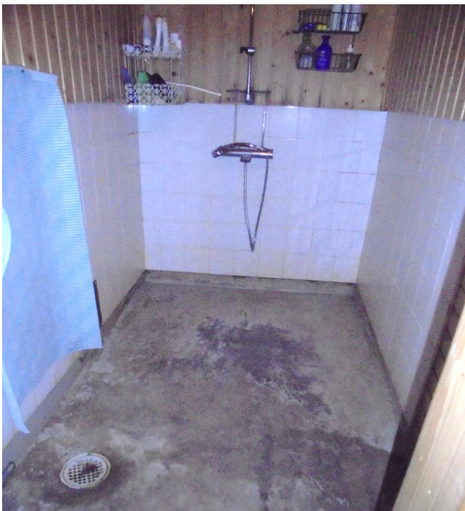
Bild 31. Golvet i badrummet är obehandlad och på väggarna finns kakel samt panel. På panelen observerades synliga skador.
