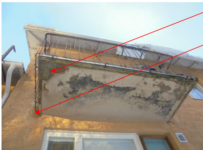
Bild 6. Delar av balkongerna har lossnat ställvis och målarfärgen flagnat.
