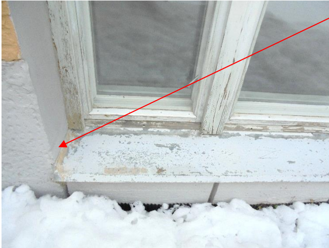
Bild 12. Fönsterplåten är otät i kanterna samt målarfärgen på fönsterkarmarna flagnar.
