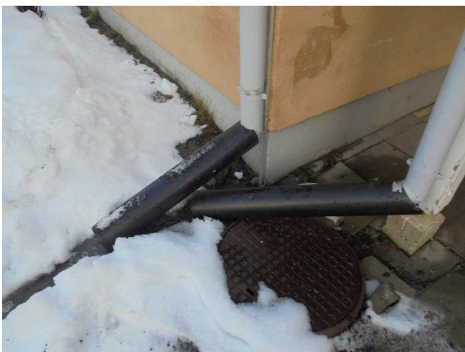
Bild 23. Regnvattnet leds inte bort från byggnaderna.
