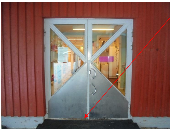
Bild 13. Ytterdörr, ställvis observerades rostfläckar i nedre kanterna.
