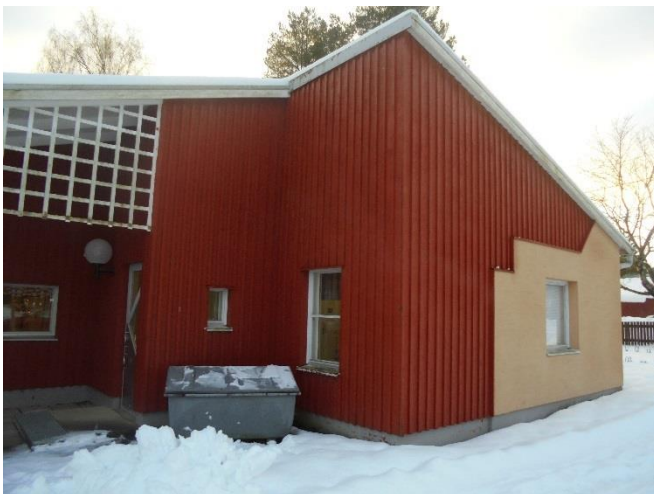
Bild 9. Panelen är bristfälligt ventilerad.
