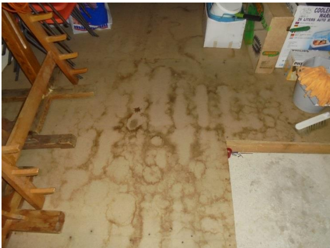
Bild 18. På golvsivorna observerades fuktmärken.
