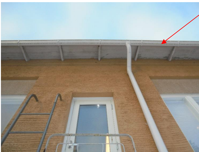
Bild 25. På undre sidan av hängrännorna observerades rinnmärken och orenheter, vilket tyder på att vattnet i rännorna inte leds bort genom stuprören.
