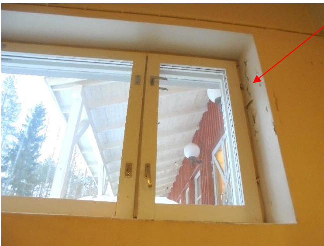
Bild 28. Ställvis flagnar målarfärgen runt fönstren i källaren. Fönstren är nära marknivå.
