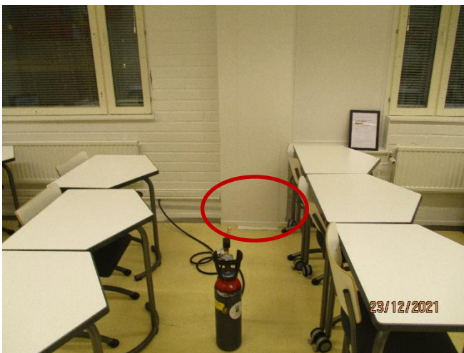
Bild 5. Spårgasen sattes in i ytterväggens nedre kant. Inget läckage konstaterades vid fönstret men nog i det markerade området vid pelaren.
