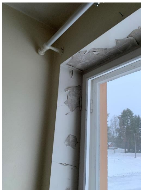
5.5.6. Fönstersmygar flagar färg och spackel
