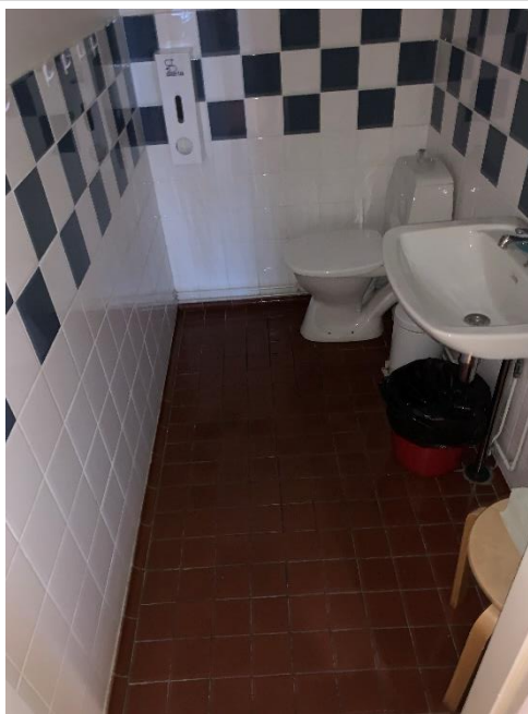
5.3.4. Wc-utrymmen, ställvist är klinker och kakel dåligt fast i underlag
