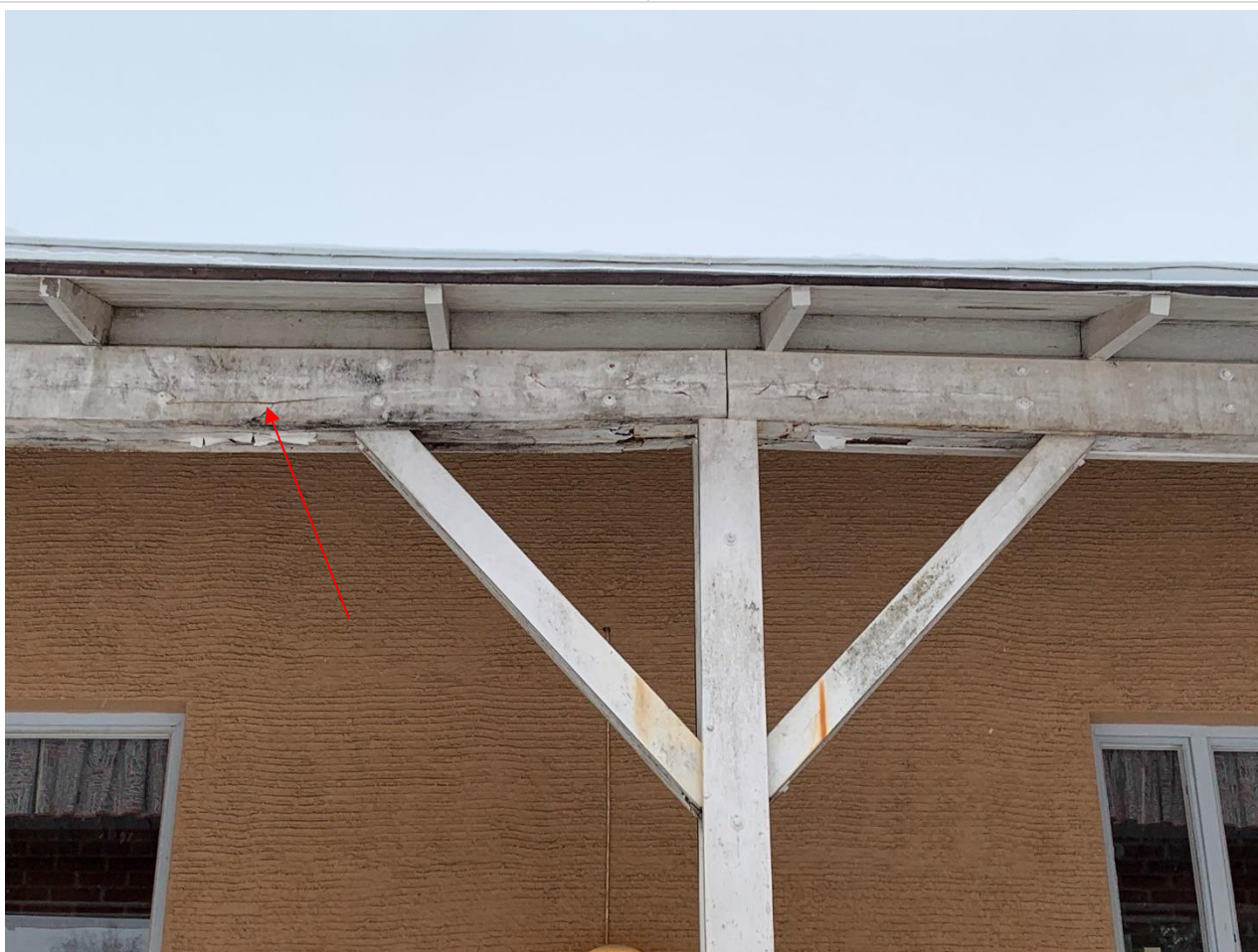
5.7.11. Träbalken ovanför skärmtaket är murken och sprucken. Området under bör spärras av och balken med dess konstruktioner bör bytas ut
