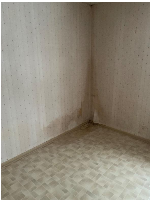
5.5.1. Fuktskador i den övre lägenheten
