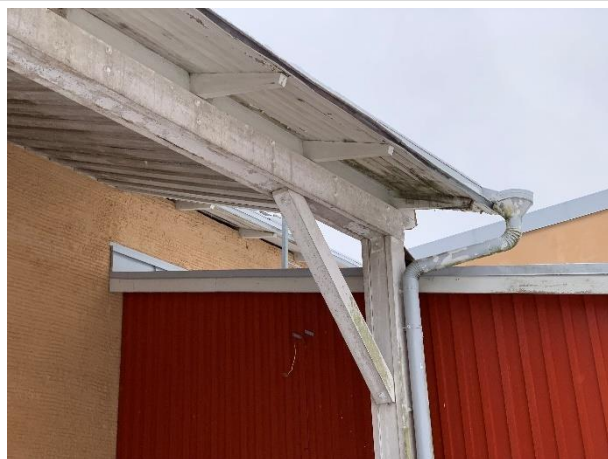
5.7.13. EN del av skärmtakets tätbrädning är murken
