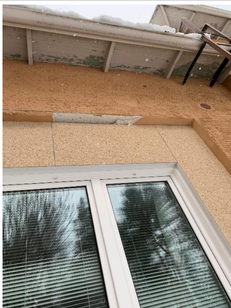
5.7.16. Rappningen runt fönstren faller ned, bör åtgärdas
