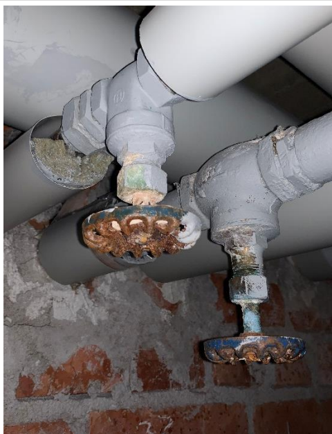
5.7.6. Gamla ursprungliga skjutventiler är en stor läckagerisk och behöver snarats bytas ut.
