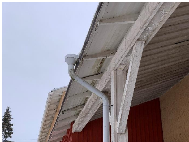
5.7.12. En del av sekundärbalkarna och tassarna på skärmtaket är murkna och bör bytas ut
