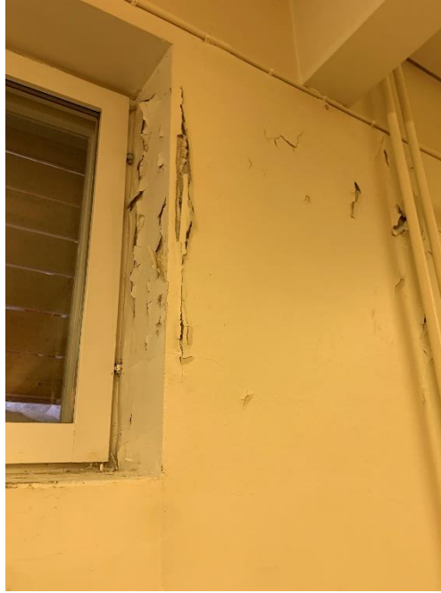
5.2.6. Ytterväggen i snickeriet var vid mätningstillfället torr men fuktskadad
