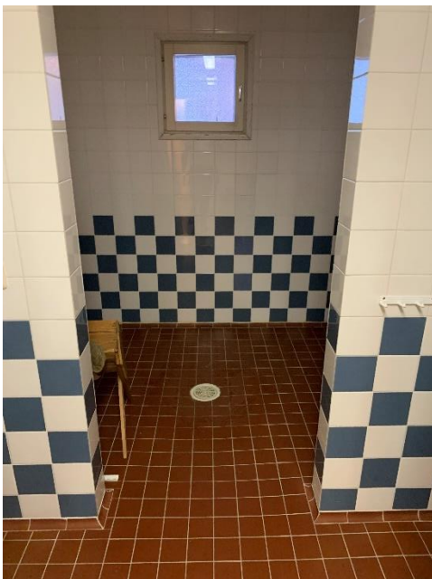
5.3.1. Våtutrymmena är ursprungliga, ställvis är klinker och kakel dåligt fast i underlaget
