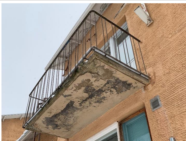
5.7.14. Balkongerna är i dåligt skick och bör läggas i användningsförbud
