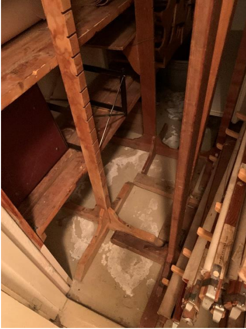
5.2.5. Golvet i förrådet belastas av markfukt
