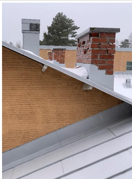
5.7.17. Övre delar av skorstenarna är i dåligt skick och bör åtgärdas
