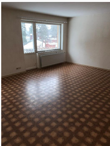
5.7.9. I den översta lägenheten finns en unken/avvikande lukt (gamla mattor avger alltid lukter) + de konstaterade fuktskadorna
