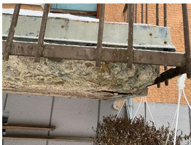
5.7.15. Balkongerna är i dåligt skick och bör läggas i användningsförbud
