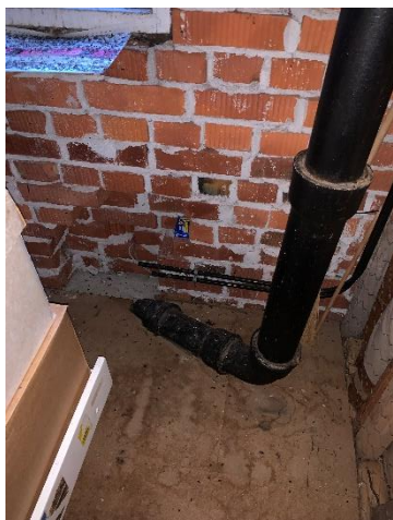
5.7.5. I den äldre delen finns avloppsrör av gjutjärn, dessa bör snarast förnyas
