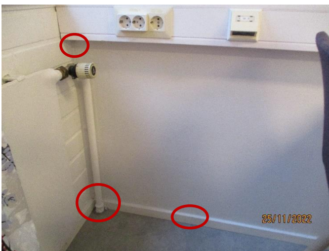
Bild 7. Läckage konstaterades i områden med röd ring. Läckaget noterades vara störst nere i hörnet vid värmeröret och det är möjligt att gasen spridit sig till övriga områden därifrån.
