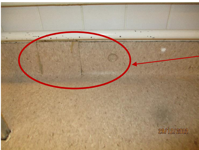
Bild 6. I norra nedre korridoren utfördes endast ett stickprov i yttervägg i rum NNHU2. Läckage konstaterades från gamla kontrollhål från tidigare undersökningar.
