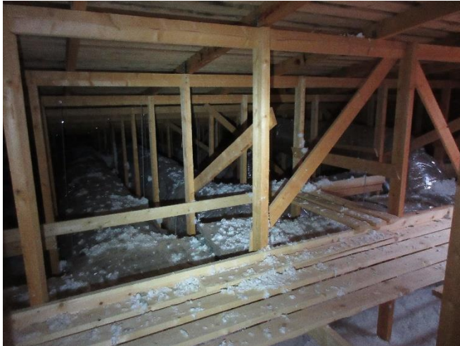
Bild 6. Synliga skador observerades ej.
