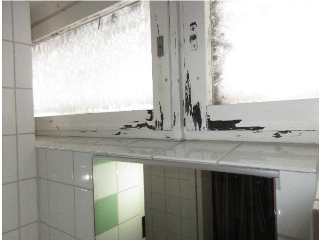
Bild 20. Ytslitage i duschutrymme på fönster. Färgen flagnar.
