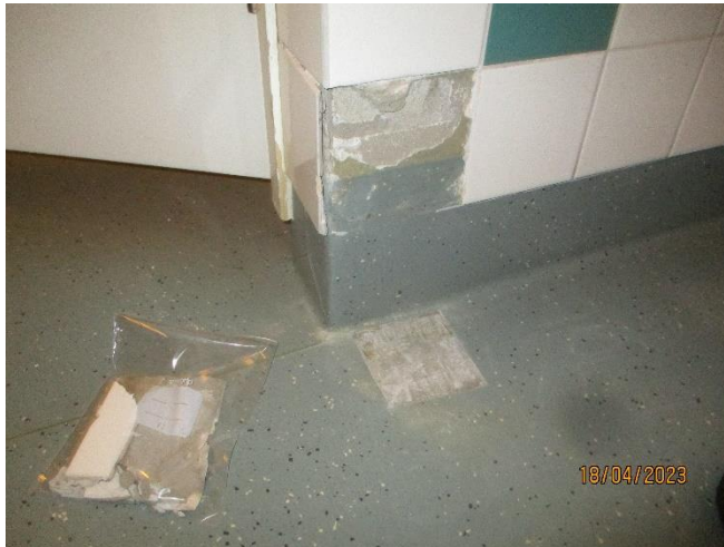
Bild 22. Asbestprov togs av ytmaterial i duschrum.
