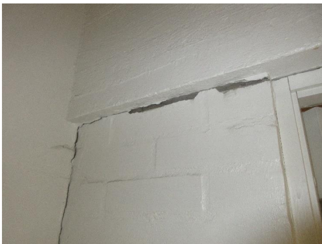
Bild 17. Gymmet. Sprickor mellan tegelvägg och balk.
