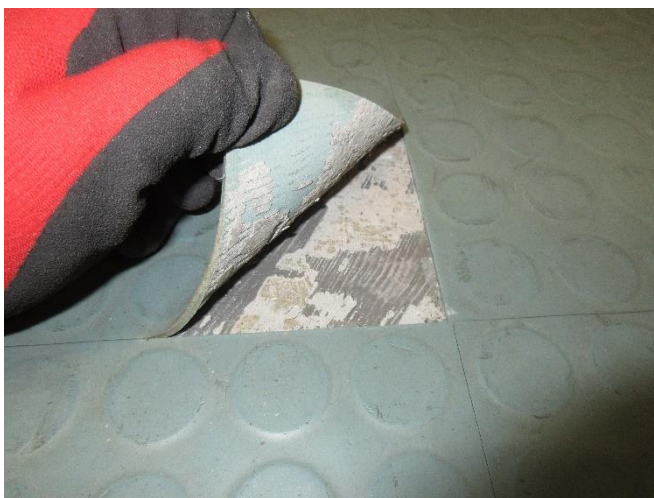
Bild 16. Plastmattan i gymmet har en avvikande lukt.
