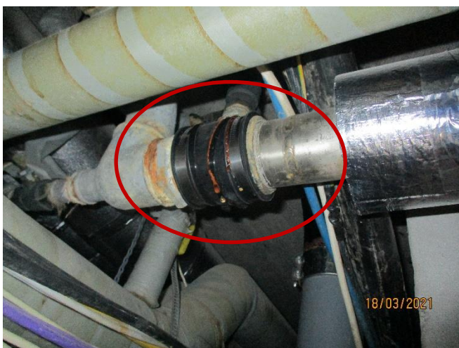
Bild 63. Ett mindre droppläckage observerades från ett värmerör i det område där teknikrum slutar och korridor in mot krypgrund börjar. Rekommenderas att man ser över och åtgärdar läckaget.
