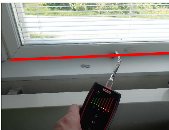
Merkkiainekoe ME.04-US, Luokka 2008, ilmavuotoa ikkunan alareunan / ulkoseinän välisestä liittymästä.
