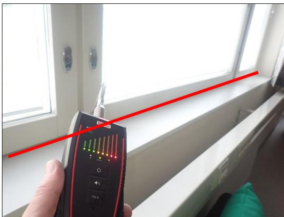
Merkkiainekoe ME.06-US, Luokka 1098, havaittiin merkittävää ilmavuotoa ikkunan alareunan ja ulkoseinän liittymässä
