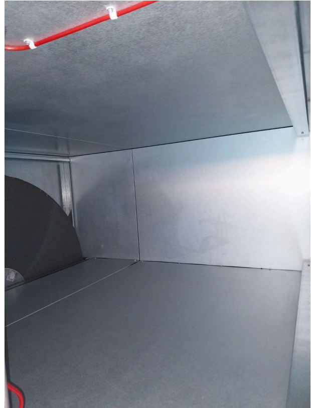
Poisto Suodatinkammio ennen
