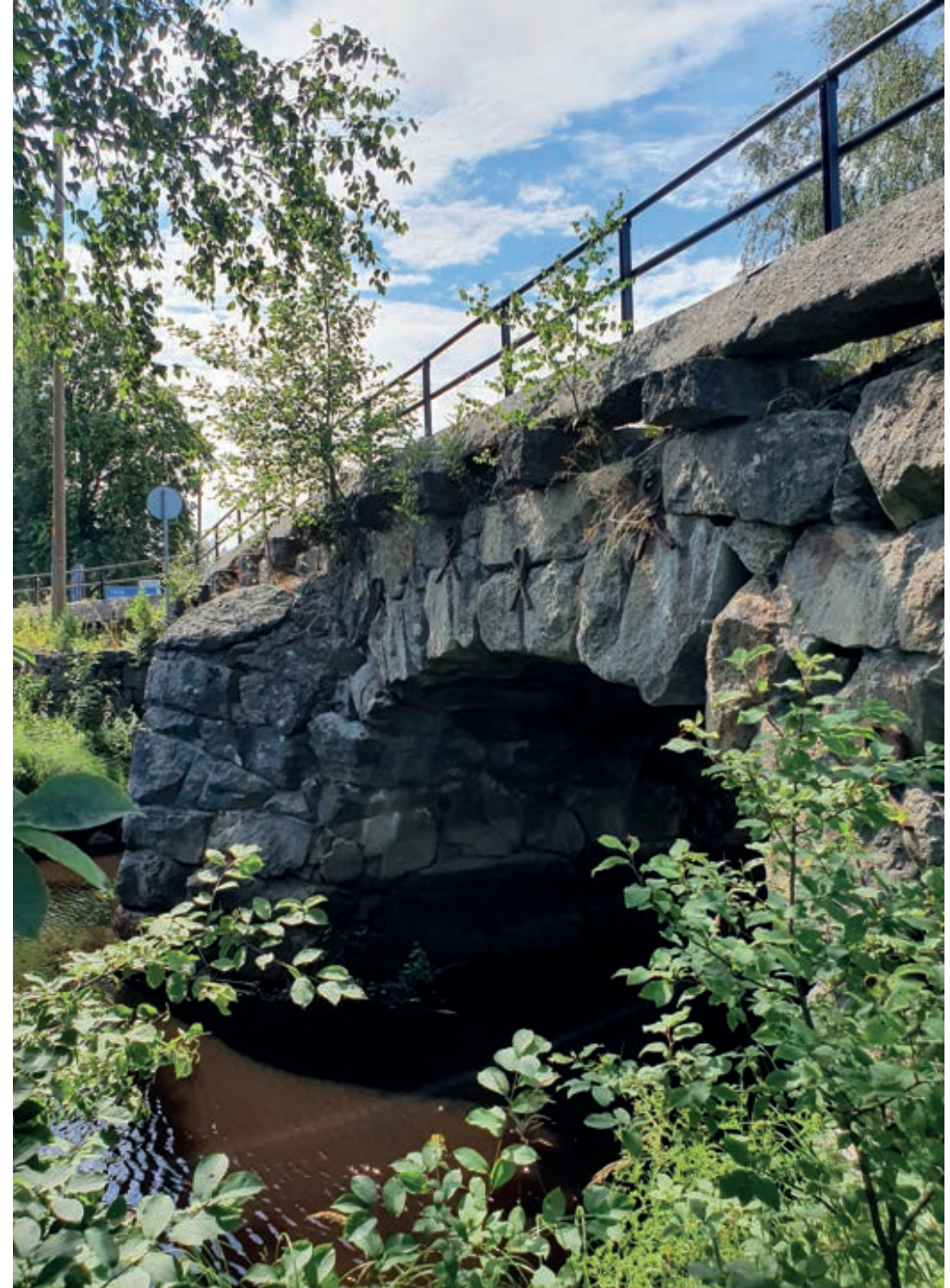
Uppe till vänster: Detaljbild på ett ankarslut på ankarjärnen, som stadgar valvbågen i söder. Till höger: Södra valvbågen med sina dekorativa ankarslut i järn.
