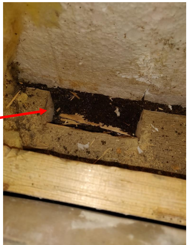
4.1.6. Fuktig styrox, sand samt syll konstaterades vid hörnet
