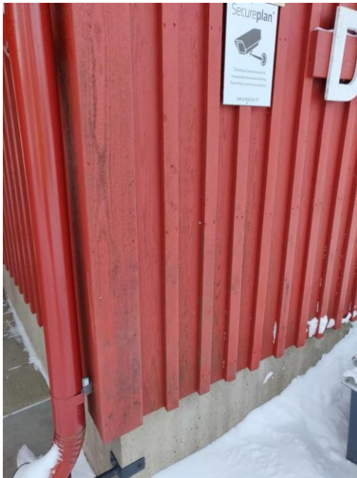
4.2.3. Fasaden har mindre områden med smuts men är överlag i gott skick
