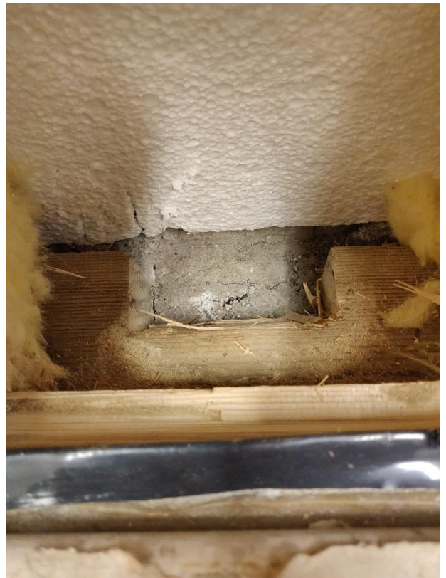
4.3.18. Materialprov av ytterväggsyll Tecken på fuktskador på gipsskivans baksida. Sockelklyvning av styrox under syllen
