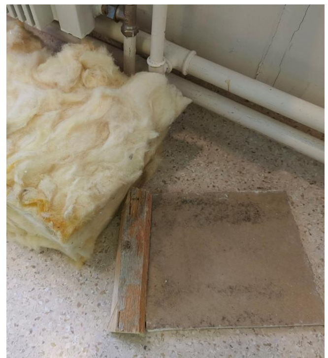
4.3.16. Materialprov av ytterväggssyll. Tecken på fuktskador på gipsskivans baksida
