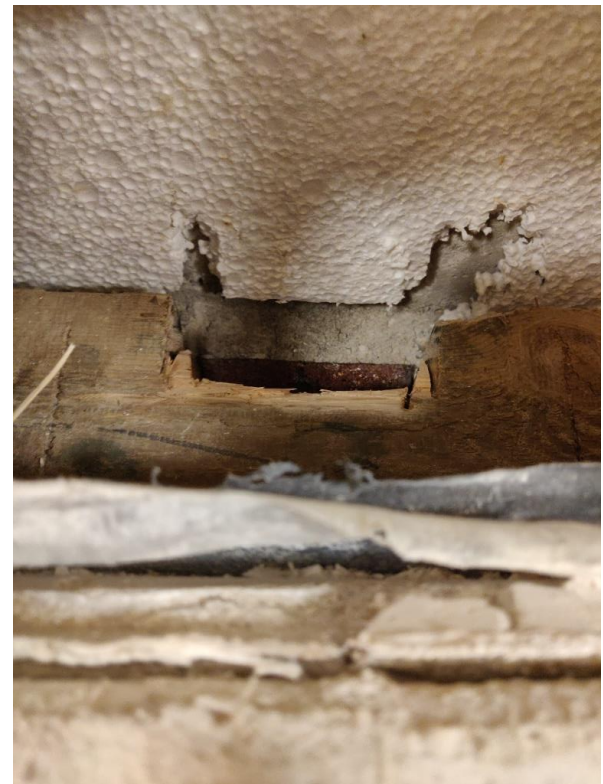
4.3.12. Materialprov av ytterväggssyll. Under syllan konstaterades bitumenfilt.
