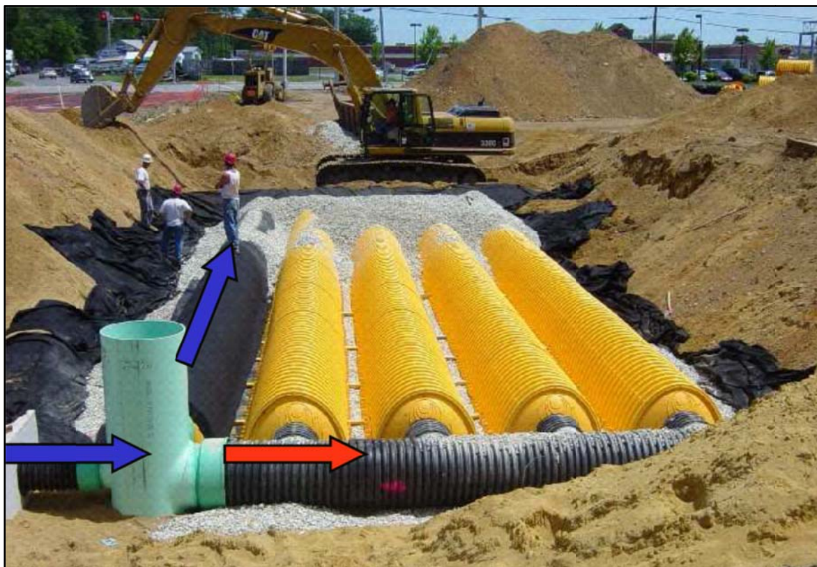
Bild 10. Underjordiska fördröjningskonstruktioner som även omfattar kvalitetskontroll 9 .
