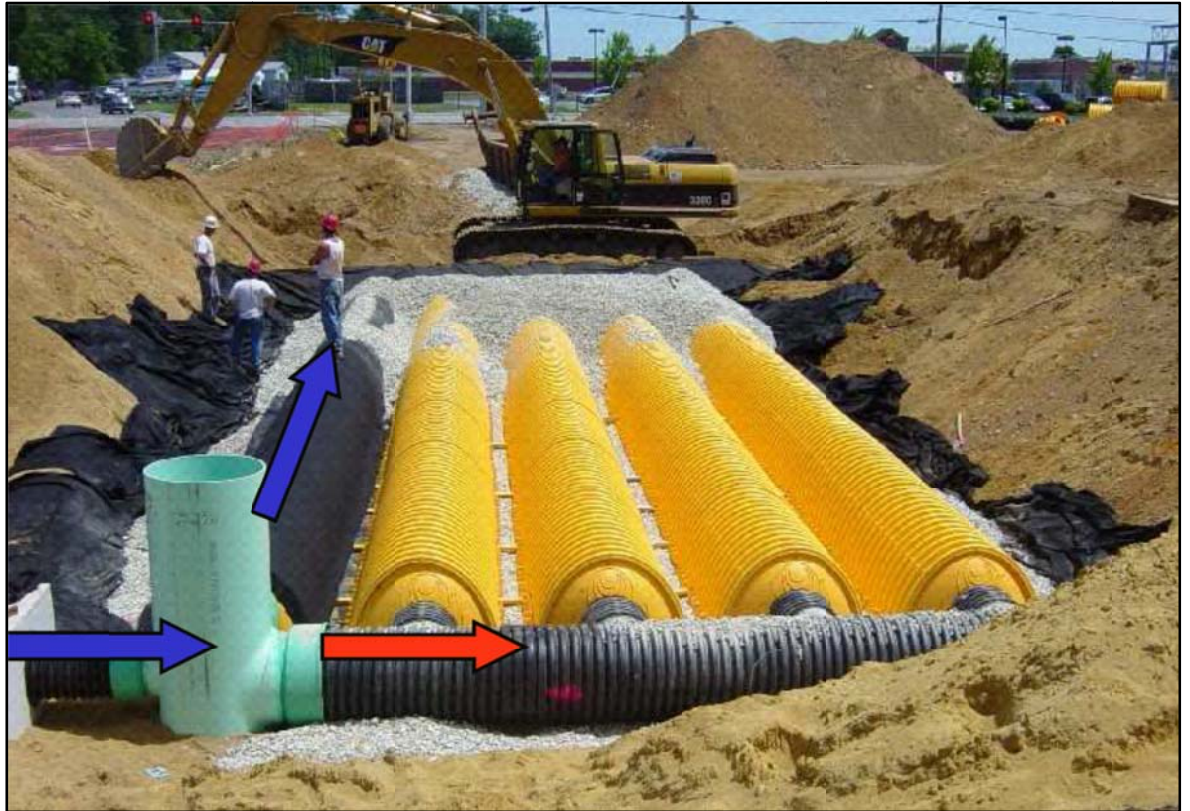
Kuva 10. Maanalainen viivytysrakente, jossa myös laadun hallintaa 9 .
